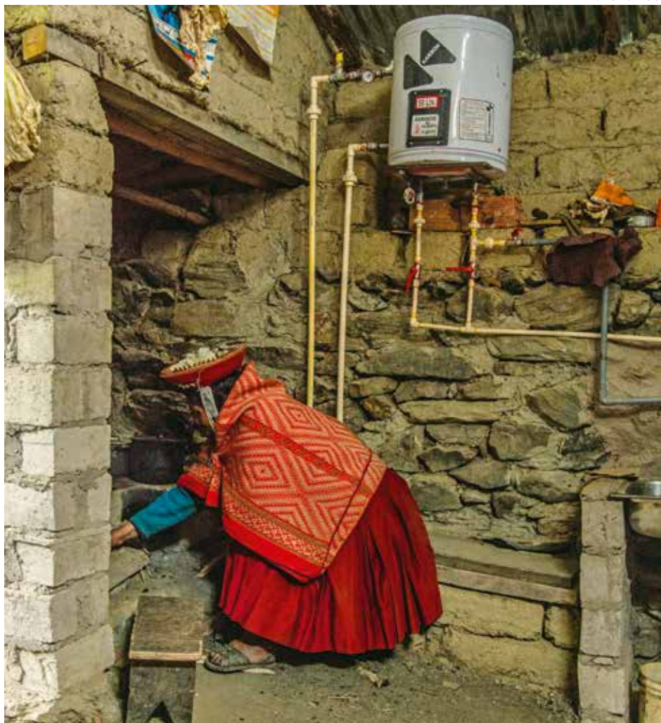
EL SISTEMA CAJAS CALIENTES UTILIZA EL CALOR GENERADO POR LAS COCINAS MEJORADAS DEL GRUPO-PUCP.
